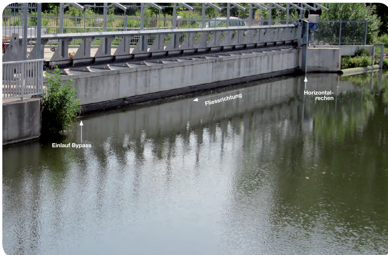
Abb. 3: Die Fischabstiegsanlage im Überblick.
