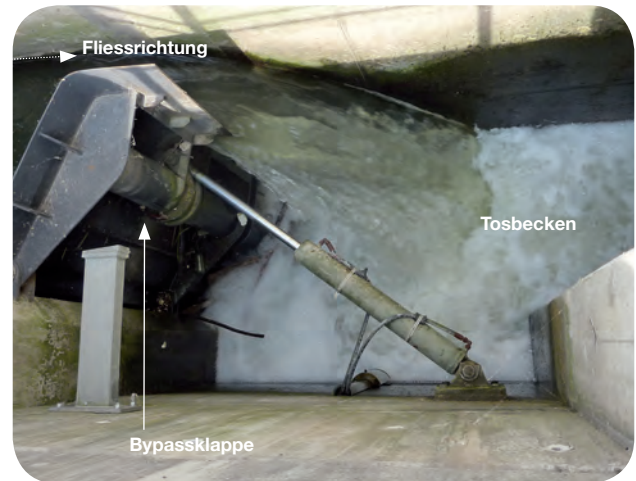
Abb. 7: Eine Bypassklappe reguliert den Durchfluss.
